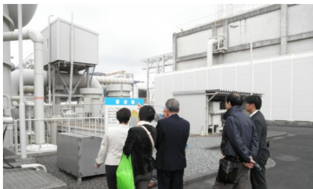
施設の説明を受ける議員団。60キロ離れた川内発電所で監視が行われ、勤務員はわずか4人です。=11月13日、鹿児島県霧島市大霧地熱発電所
