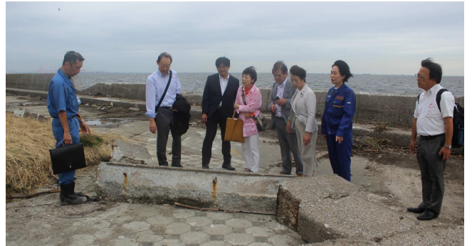
崩れた岸壁を調査する党市議団と畑野衆院議員=9/13
